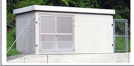
Podstacja transformatorowa SN/nN
